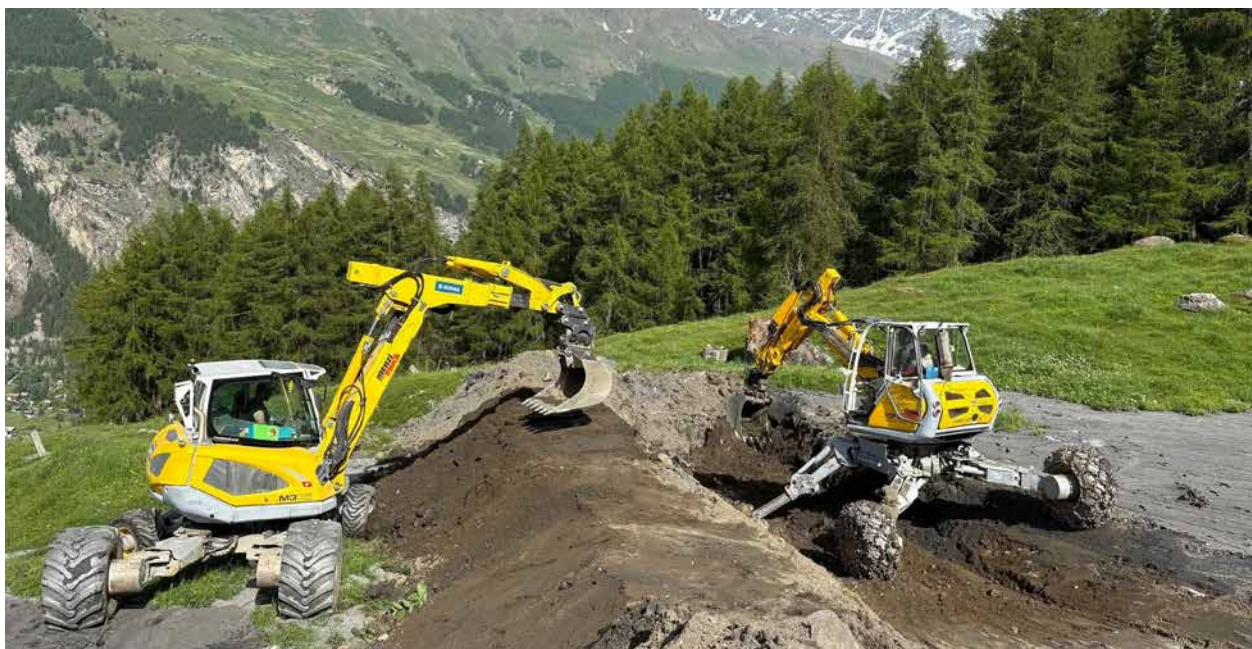
SÉCURISATION EN URGENCE D'UNE ROUTE DANS LA RÉGION D'ÉVOLÈNE.
